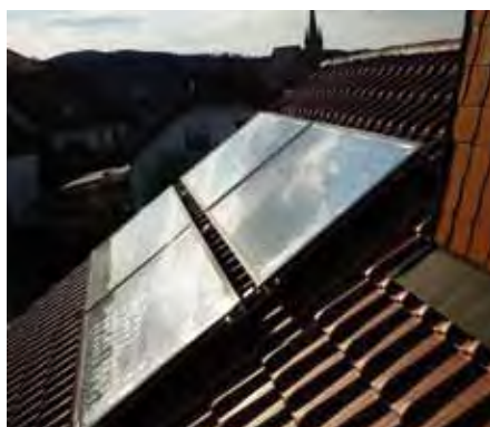
Panneaux solaires modulaires en sur-toiture (ASK)
