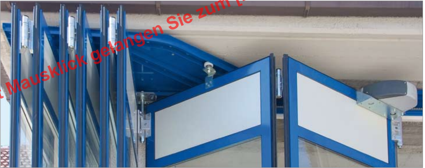
SFT mit Automat im Bahnhofsbereich
